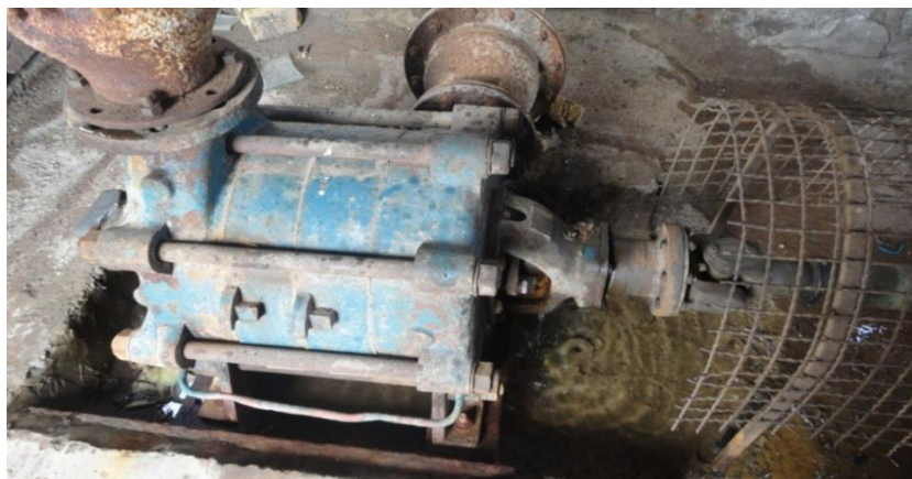
شکل ۶- نشت آب از پمپ به دلیل استهلاک تجهیزات آب بندی پمپ
