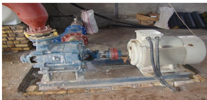
شکل ۲- نمونه‌ای از اجرای نامناسب ایستگاه‌های پمپاژ آب کشاورزی
