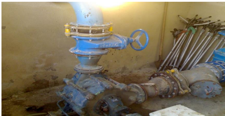
شکل ۳- نمونه‌ای از اتلاف انرژی در ایستگاه پمپاژ به دلیل استفاده از تجهیزات نامناسب کنترل جریان
