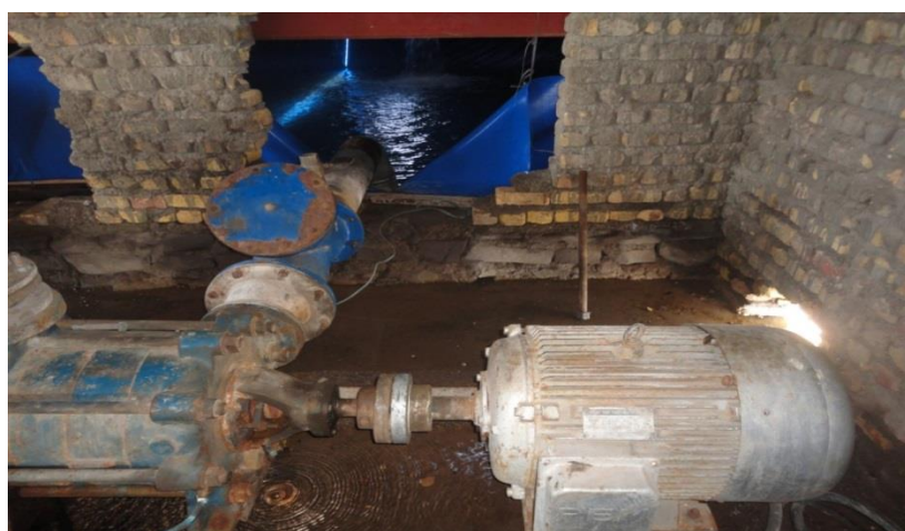
شکل ۷- نشت آب از پمپ به دلیل روش اشتباه راه‌اندازی ایستگاه پمپاژ
